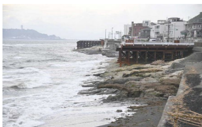
深刻となっている砂浜の浸食
