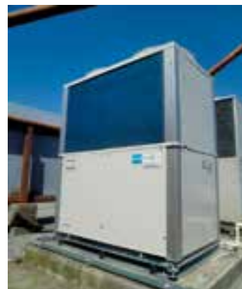
ガスヒートポンプエアコン設置例
