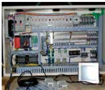
制御盤内配置
