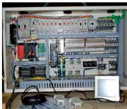
制御盤内配置
