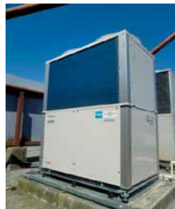
ガスヒートポンプエアコン設置例
