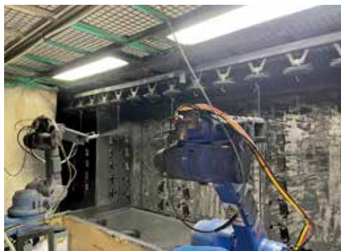
塗装ロボット及び除塵設備
