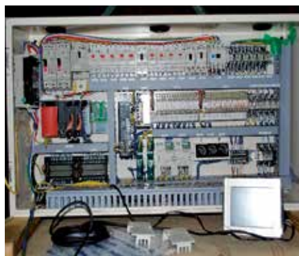
制御盤内配置
