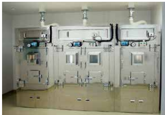
放射性薬剤製造装置
