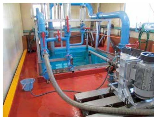
ポンプ性能試験
