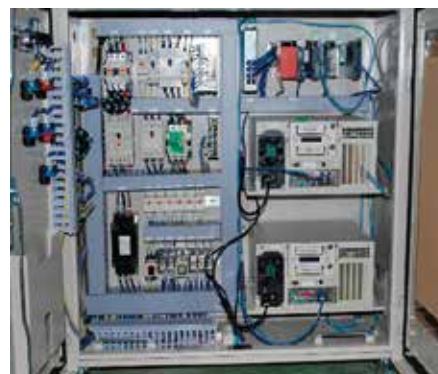
制御盤内配置
