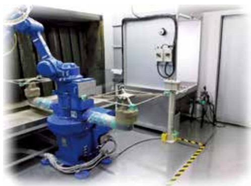
塗装ロボット及び除塵設備
