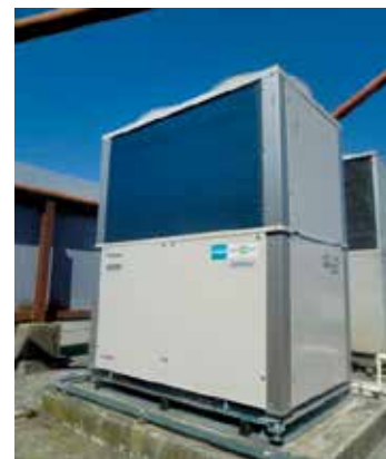
ガスヒートポンプエアコン設置例
