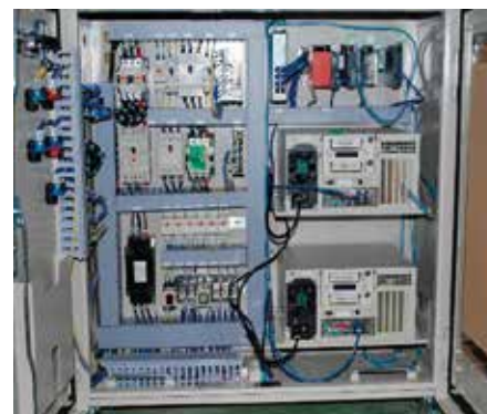
制御盤内配置
