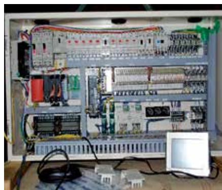
制御盤内配置
