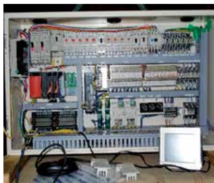
制御盤内配置
