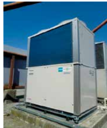
ガスヒートポンプエアコン設置例
