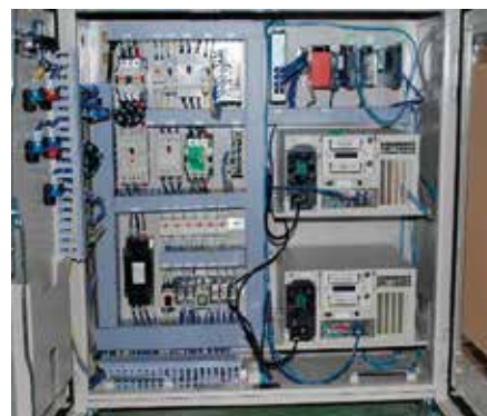
制御盤内配置
